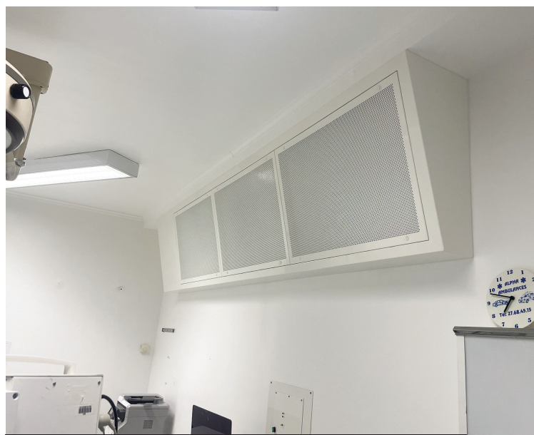
Les tôles perforées de diffusion sont démontables par quart de tour. Les perforations permettent de couvrir l'ensemble du bloc opératoire.
