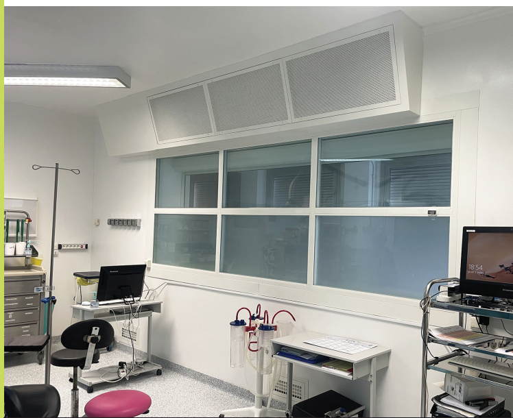
La poutre filtrante a été installée en lieu et place des anciennes grilles de soufflage. Les grilles de reprise d'air assurent un champ plus propre.
